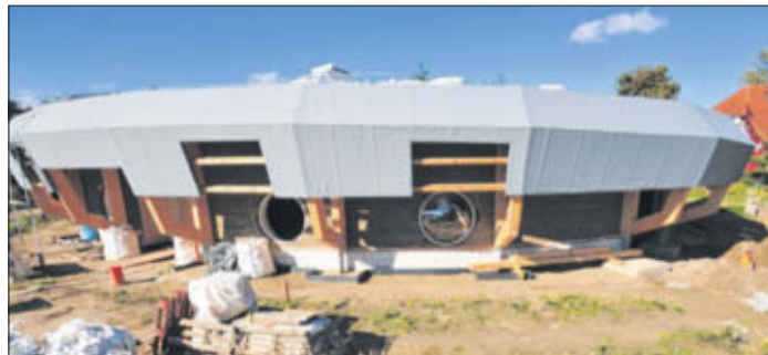
Das „UFO“ am Rande von Garz, ein innovativer Kindergarten-Neubau des DRK-Kreisverbandes. Fotos (3): Holger Vonberg
